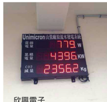
欣興電子 山鶯廠放流水發電系統
